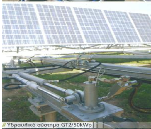
// Κεντρική υποδομή GT2/50kWp
